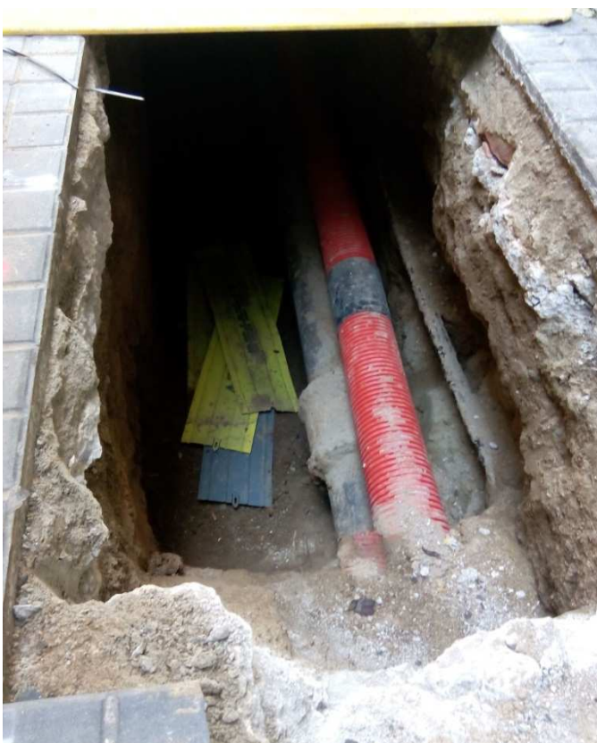
Vista del carrer Bassegoda amb les proteccions de la rasa excavada i detall de un dels punts excavats.
